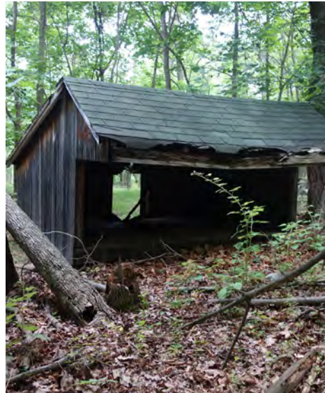
Broken camping structure (Image 3.4.4.3).
